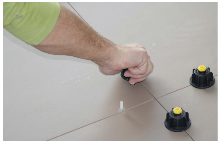
Zughaube auf Gewindelasche schrauben und mit wenigen Umdrehungen die Fliese auf das gewünschte Niveau anheben
